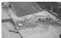
„Reška“ tj. prekid u hidroizolacijskom sloju
