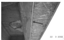
Procurivanje kroz AB ploču kolnika i konzolu pješačke staze mosta kod Zaprešića
